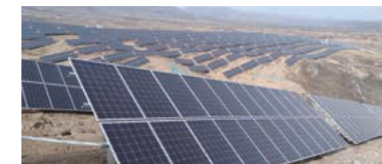
山西省太原市阳曲县杨兴乡光伏扶贫电站
